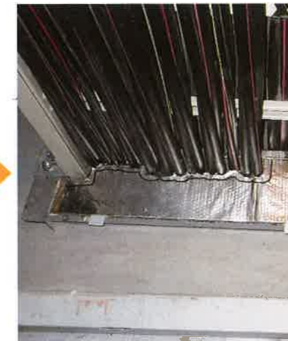
⑤ Jボードを加工し、鋼製枠の内側に耐火接着剤を塗布して設置します。
