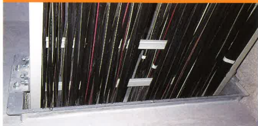
① 両面ラック部の占積率を確認する。(20.2%以下) ※床置架台の設置方法によっては、ケーブル布設前に先行して、床置架台の下部に耐火接着剤を用いてJ-ボードを設置します。
